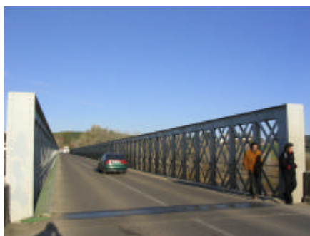
Puente acceso a la estación sin acerado
